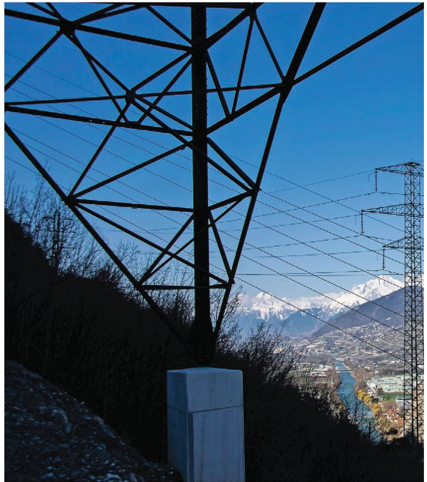
La Suisse détient une position géographique de choix, en plein cœur de l'Europe, en matière de déploiement du réseau électrique.
